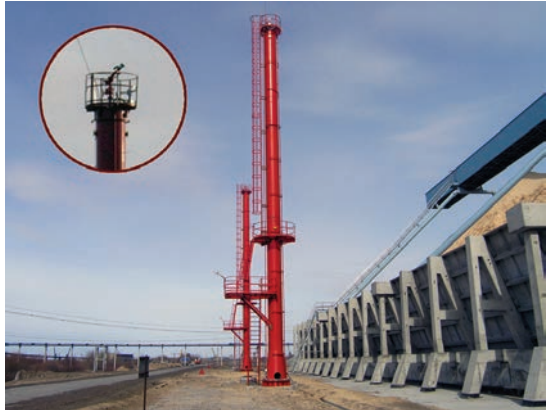
Рис. 8.14. Система пожаротушения древесно-подготовительного цеха Архангельского ЦБК
