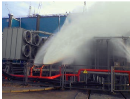
Рис. 9.19. АУП-АСо на ПС 500 кВ Новокаширская
