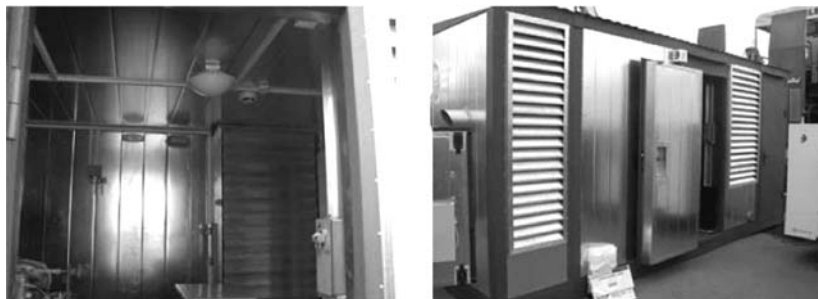
Рис. 6.12. Пример защиты модуля дизельной электростанции автономной установкой порошкового пожаротушения.
