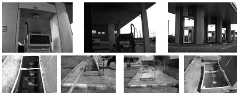
Рис. 6.14. Пример защиты АЗС автоматическими средствами пожаротушения в автономном режиме.
